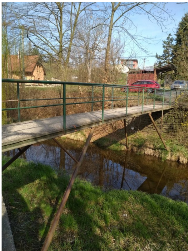
Obr. 5: Mostek z ulice Bělídlo na ulici Procházkova - místo omezující odtokové poměry
